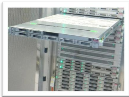
Abb. 4: Ausgezogener Serverknoten und ZFS Storage Appliance
